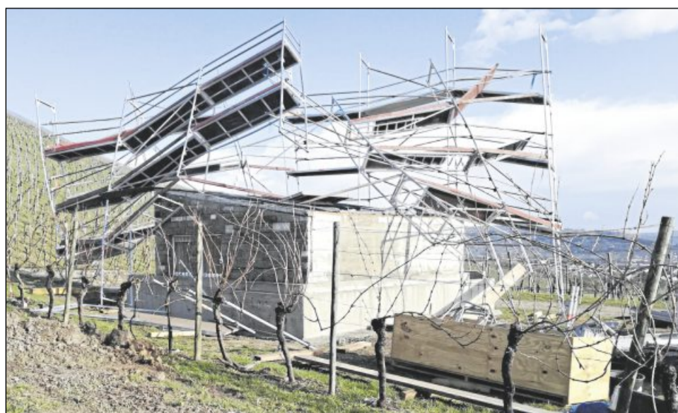
Das Gerüst konnte den Böen nichts entgegensetzen.
