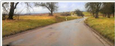
Unzureichende Fahrbahnbreite, ausgefahrende Seitenränder in jeder Fahrtrichtung
