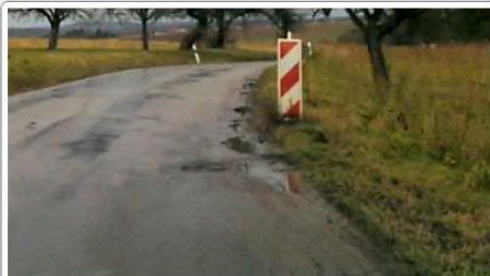
Seitenränder sind weggebrochen - Schlaglöcher
