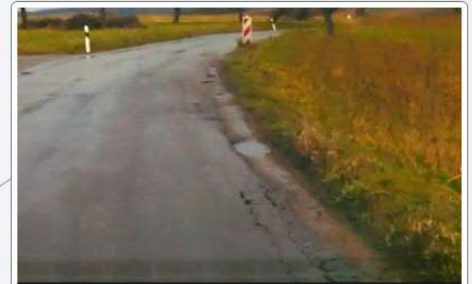
Risse in der Fahrbahn - Feuchtigkeit und Tausalze können ungehindert eindringen
