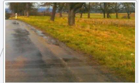
Seitenränder abgesackt - Schlaglöcher
