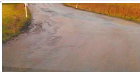
Ausgebesserte Stellen und mangelnde Griffigkeit
