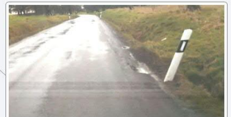
Verdrückungen im Asphalt auf großen Teilen der Strecke
