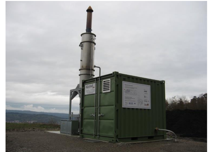
Fackelanlage Deponie Schorndorf
